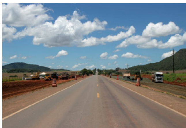
Figura 6: Atividades de ampliação da área de pavimentação com utilização da escória às margens da Rodovia da Concessionária
