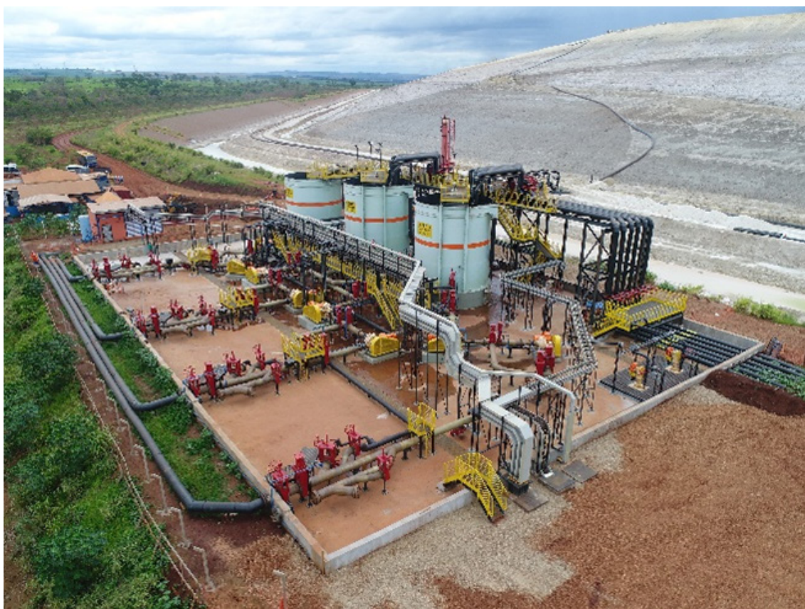
Figura 1: Unidade de bombeamento de gesso U-640 (Mosaic Fertilizantes)
