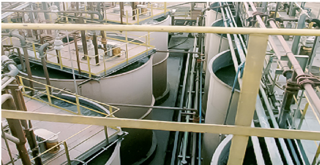
Figura 17: Tanques com agitação (à esquerda) usados na lixiviação de minério.
