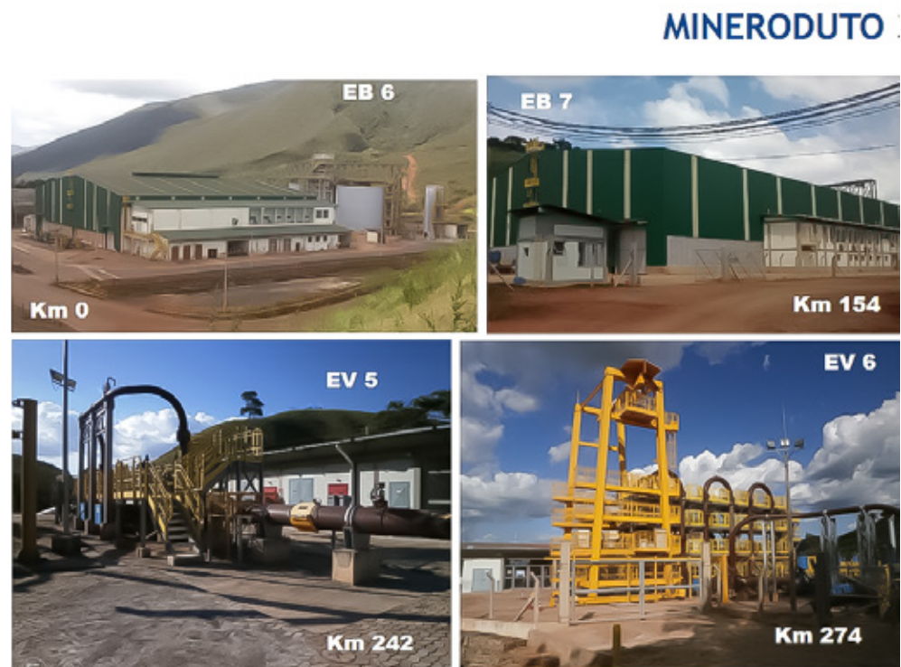
Figura 20: Estruturas do mineroduto 3.
